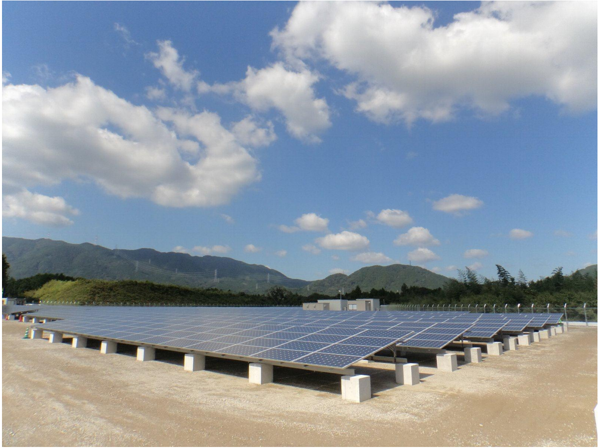
「宮若発電所」の全景
