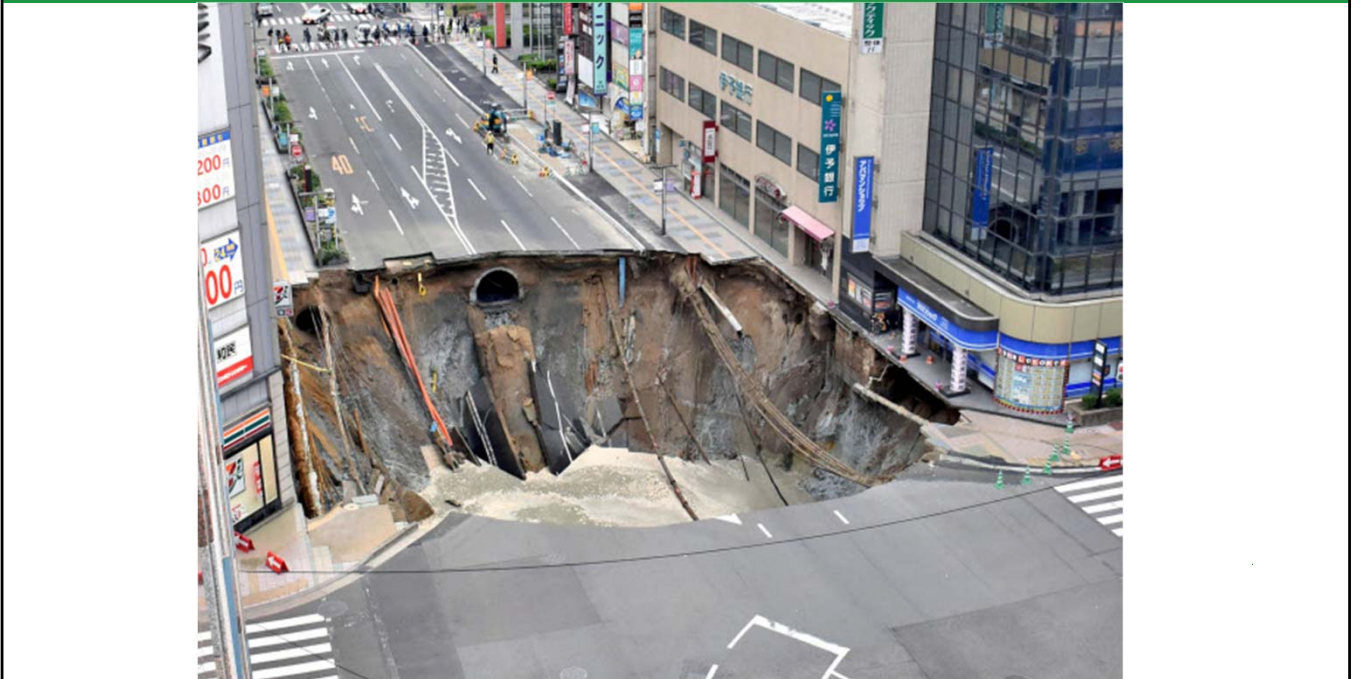
2016年に起きた博多駅前道路陥没事故の画像です この事故の普及に西部電気工業が携わっております
