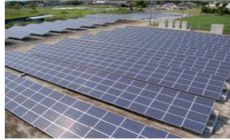
合志発電所 430kw (熊本)
