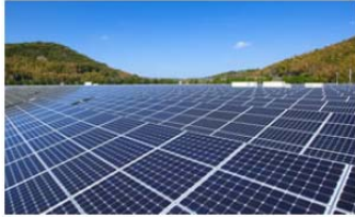
津屋崎発電所 1,570kw (福岡)
